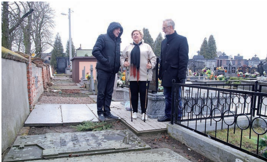
Konsultacje wykonawcy Marka Daszkiewicza z inwestorem przed rozpoczęciem remowacji płyt nagrobnych Franciszki Głuchowskiej i Wincentego Cygańskiego.
